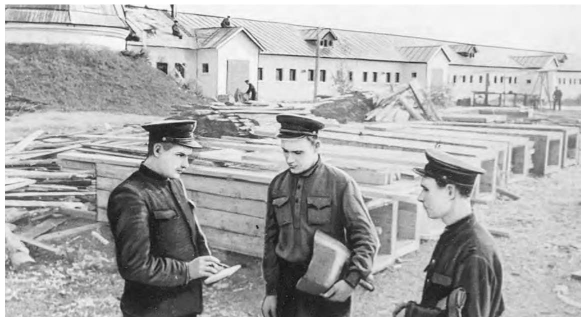
Работники Инского паровозного депо помогают артели им. Жданова Новосибирского района на строительстве нового скотного двора (слева направо): бригадир Кравченко Г.Ф., электросварщик Слепынин М.А. и плотник Яворский В.И.
